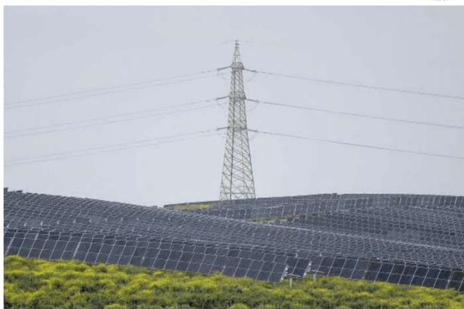
Planta fotovoltaica en la localidad sevillana de Guillena. PACO PUENTES
